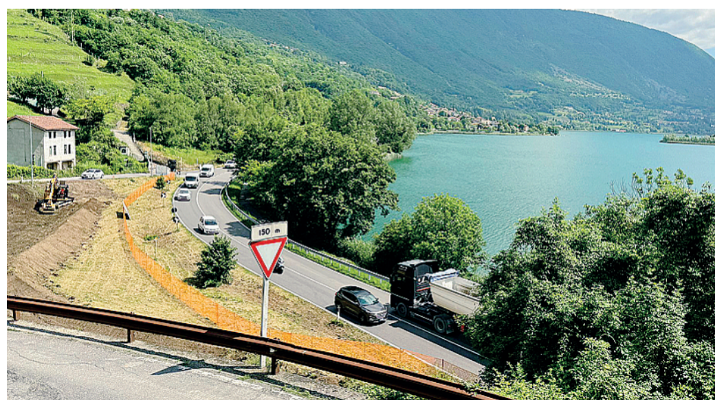
I lavori in corso per allargare la via Lovere, in primo piano, strada che porta da Ranzanico alla Statale 42
